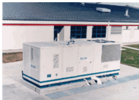
Rys. 6. Genrator z rys. 5 w Cinergy USA.
